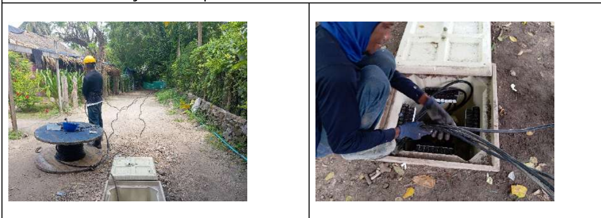
Cableado Red de BT
