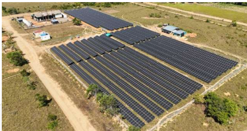
Contrato 144 de 2021. Proyecto Central de Generación Híbrida Cumaribo -SCYS
