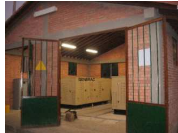
➤ Vista de los grupos electrógenos. Diciembre de 2008
