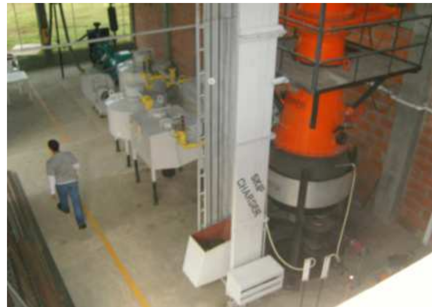
>Vista general de equipos del proceso de gasificación y generación de energía. Julio de 2008
