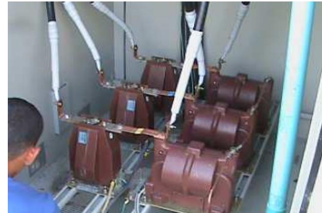
Transformadores de Instrumentación (Tensión y corriente) Fuente: CNM
