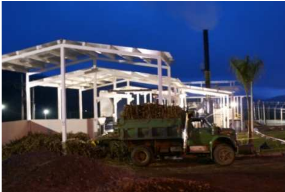
➤Panorámica de la planta de bioetanol. Enero 2009
