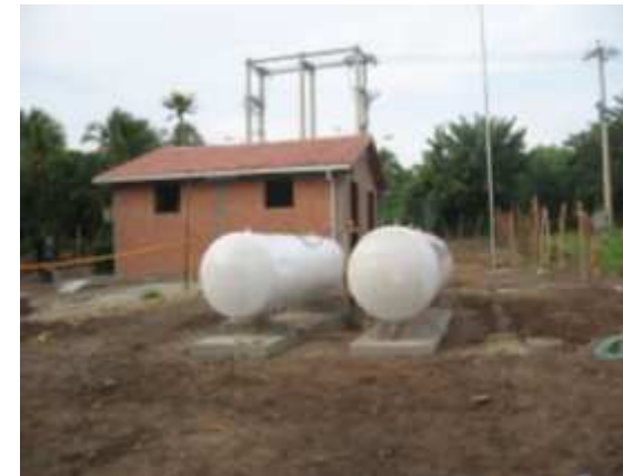
CASA DE MÁQUINAS
