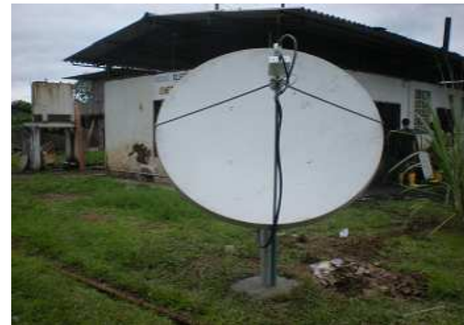
Antena VSAT para comunicación satelital Geoestacionaria, instalada en ZNI Fuente: CNM
